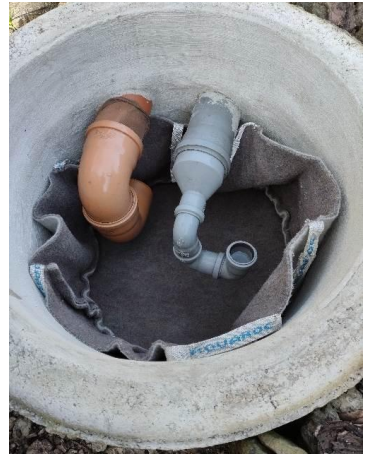
Filter für den Zulauf in die Zisterne: Die Anlage wurden 1994 in Eigenleistung eingerichtet und wird seitdem mit großer Zufriedenheit genutzt. Der Filter wird je nach Verschmutzung oder Starkregenereignisse 2 bis 3 Mal jährlich gereinigt. Foto: Manfred Röhner
